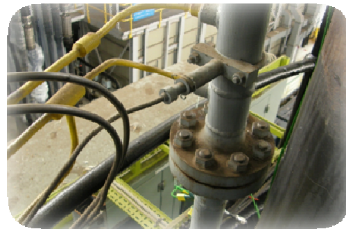
F2 Venturi Meter & RTD Element
